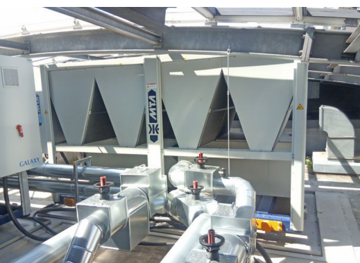
Die isolierte Verrohrung der Kaltwassersätze mit Absperrventilen und Schmutzfängern
