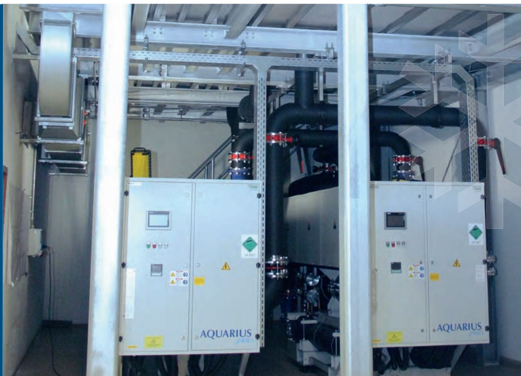
2 x AQP 1852 SSN mit S7-Steuerung, TP-Grafikdisplay und Siemens PAC 3200-Energiemesssystem
