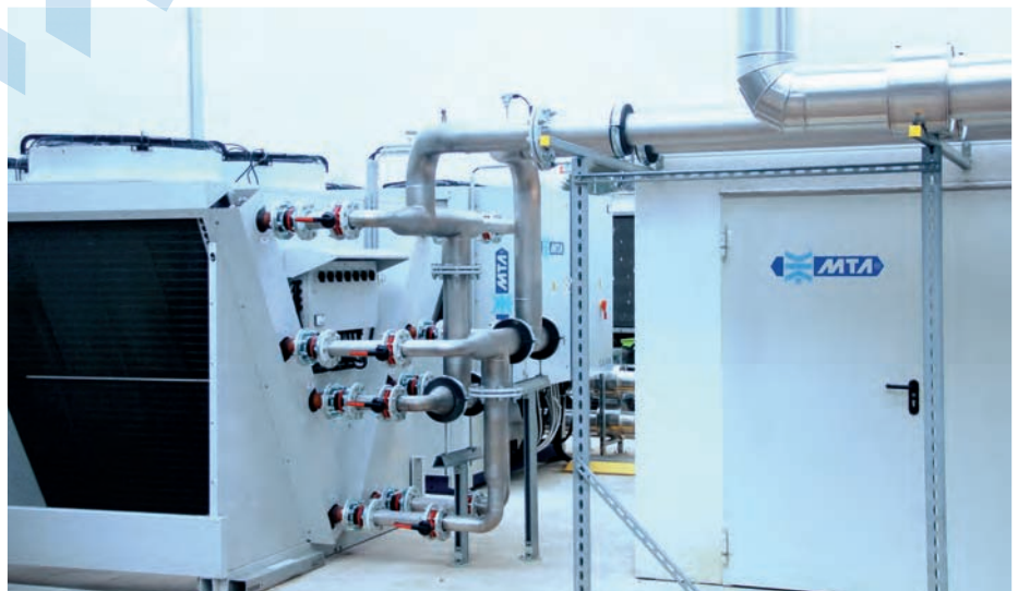
Das Gesamtsystem wird über einen MTA-Zentralschaltschrank mit einer S7-Steuerung und MTA-Energiemanagementprogramm überwacht.
